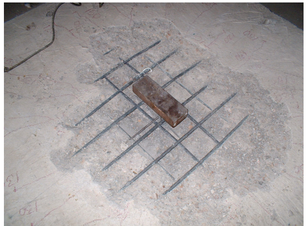
Figura 16 - Superfície de ruína da laje L2 após remoção do material colapsado
