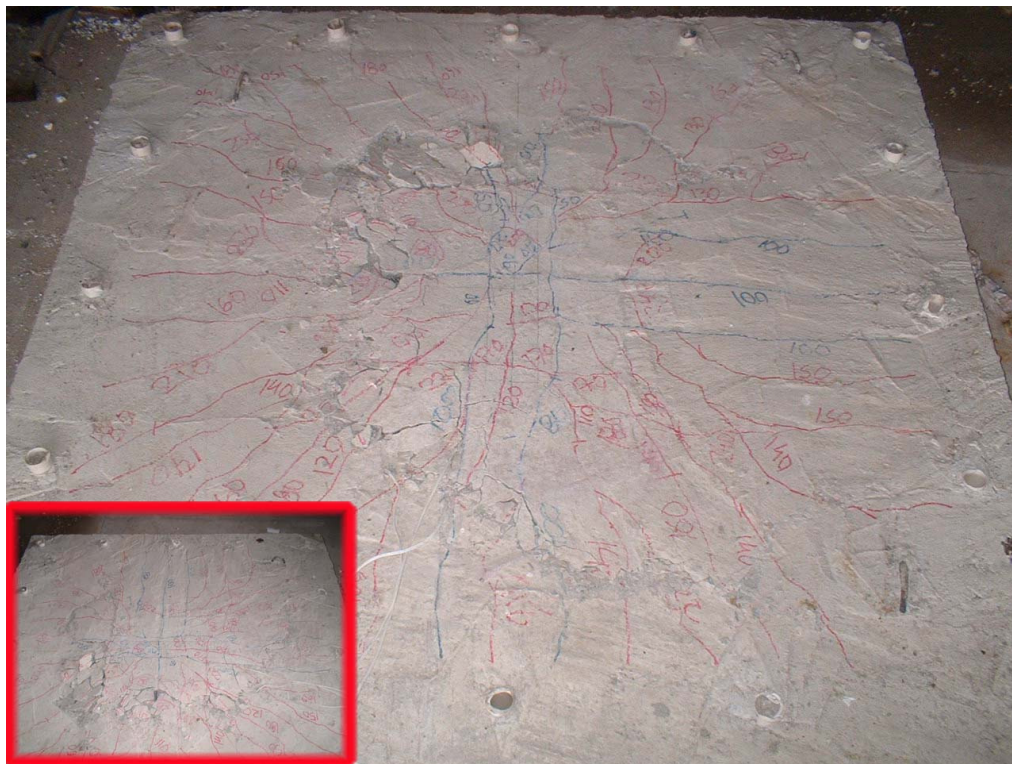
Figura 6.62 - Fissuras desenvolvidas na face superior da laje L3
