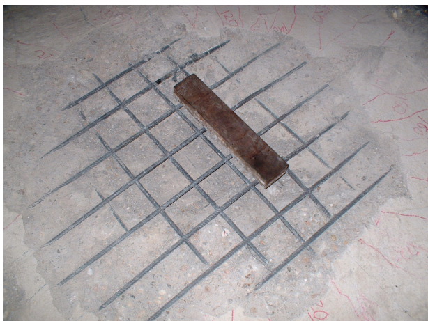
Figura 17 - Superfície de ruína da laje L3 após remoção do material colapsado
