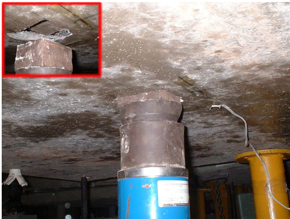
Figura 6.76 - Face inferior da laje L1 após o ensaio
