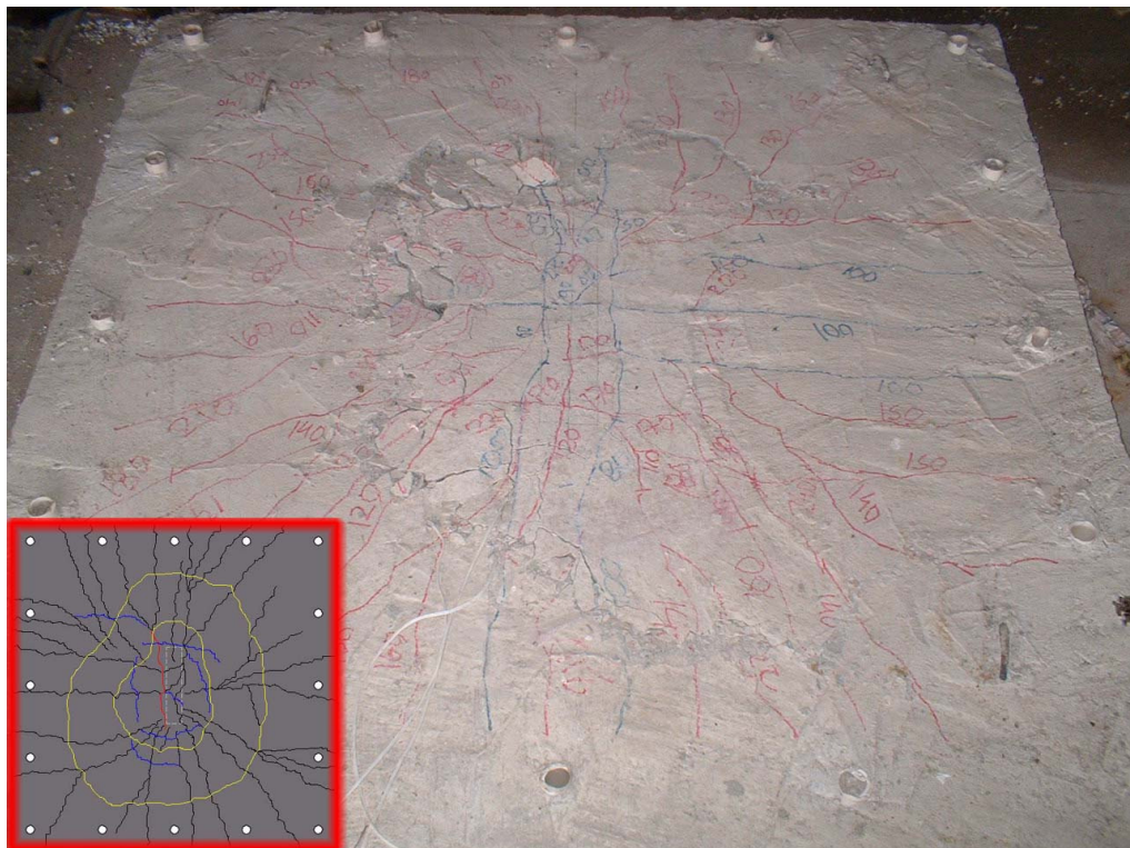
Figura 6.79 - Face superior da laje L3 após o ensaio
