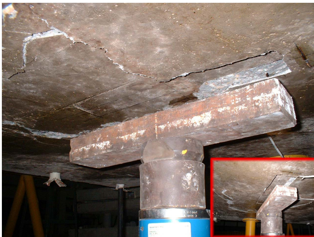
Figura 6.80 - Face inferior da laje L3 após o ensaio
