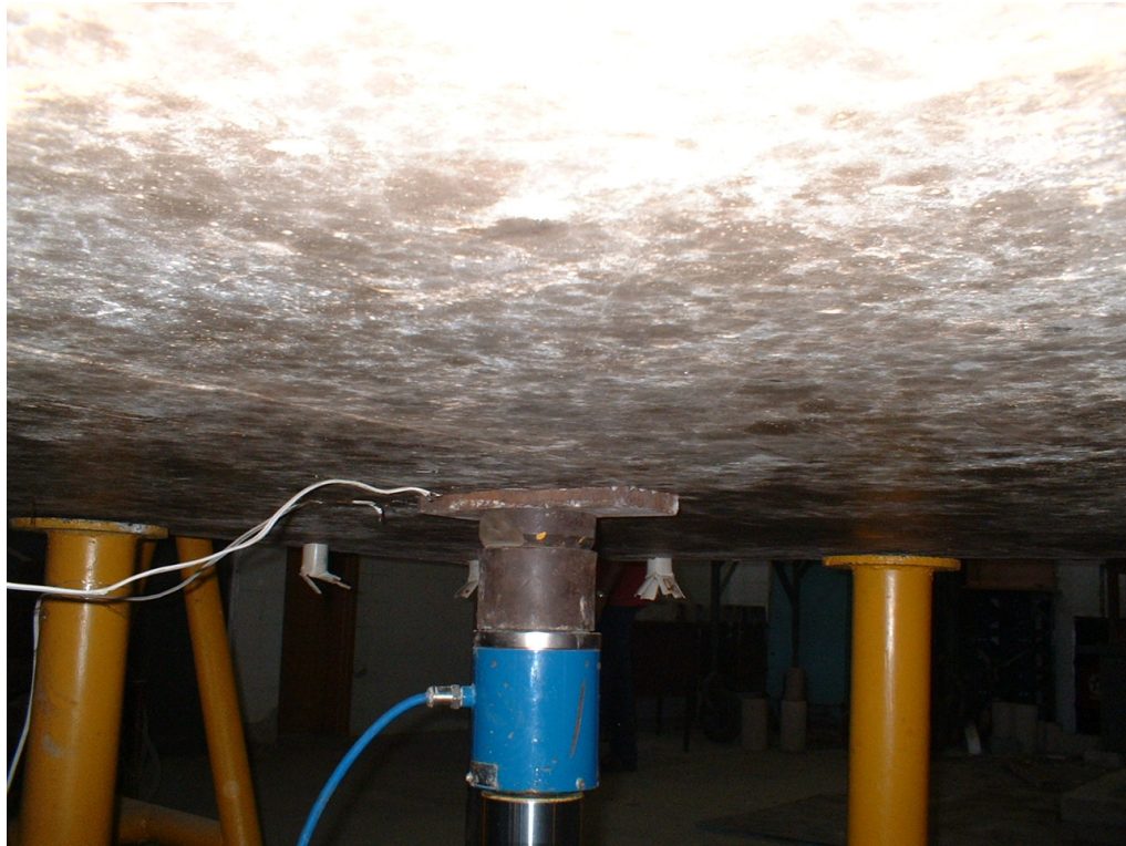
Figura 6.84 - Face inferior da laje L5 após o ensaio
