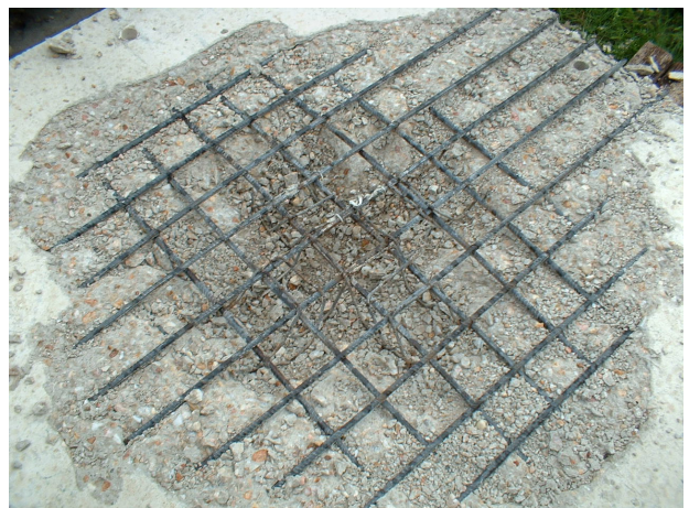
Figura 18 - Superfície de ruína da laje L4 após remoção do material colapsado
