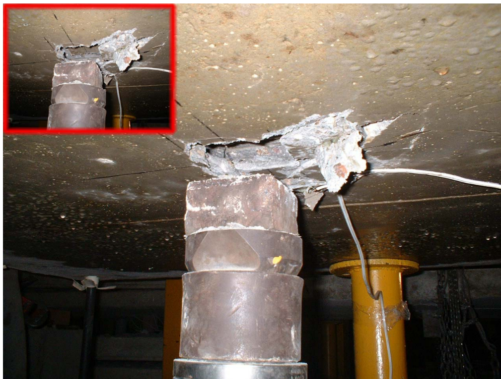
Figura 6.82 - Face inferior da laje L4 após o ensaio
