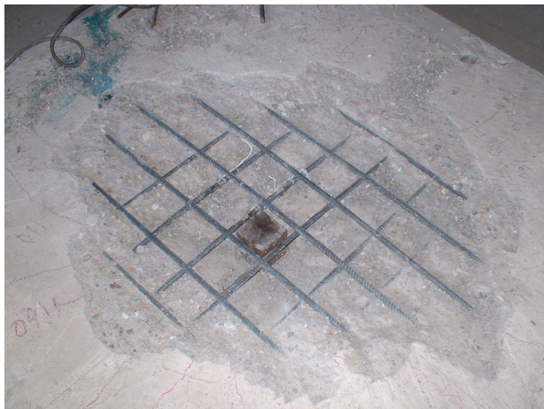
Figura 15 - Superfície de ruína da laje L1 após remoção do material colapsado
